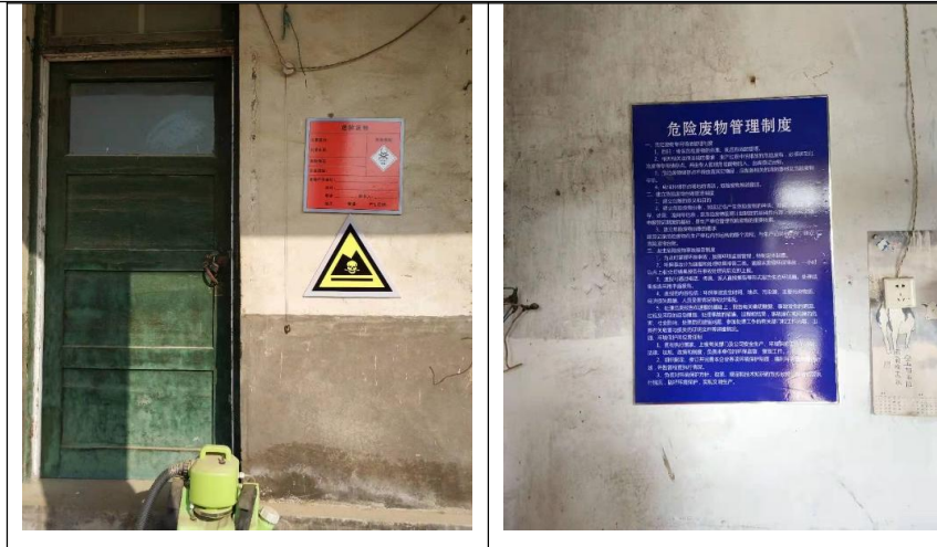
图 2.6 现有危废暂存间
